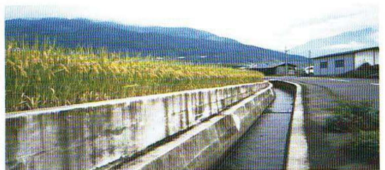
▲ 宮入貝対策のコンクリート溝渠
